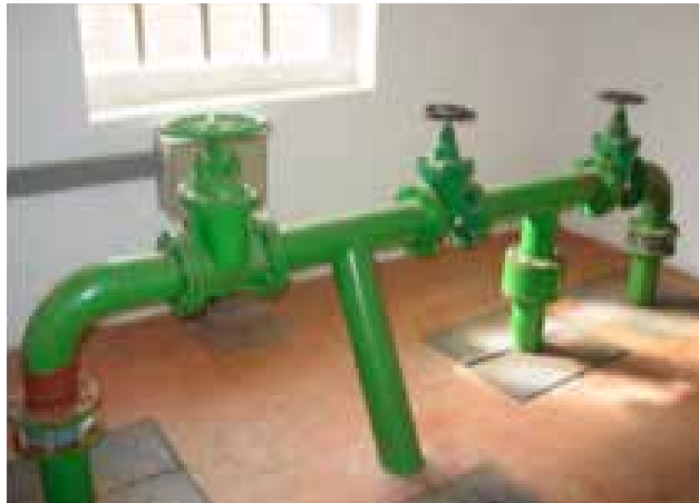
Cambra de claus de l'estació de bombament de Mont-ras
