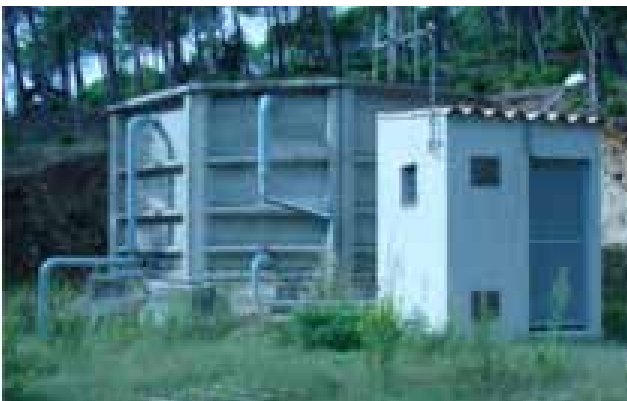
Dipòsit i cambra de claus de Can-Burjats
